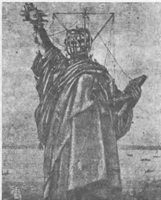
137. Statua Wolności w budowie. Dar Francji dla Stanów Zjednoczo- nych w 1885 r.
